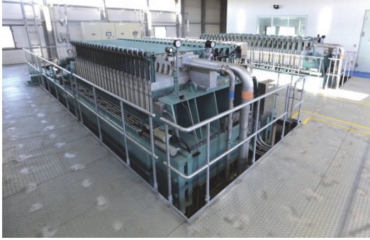
犬山浄水場 脱水機
